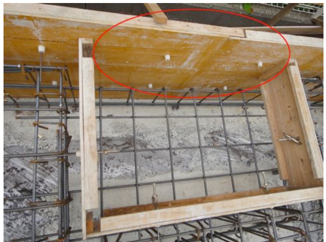
【外周部設備配管等の確認】 トイレ下部の先行設備配管の確認です。基礎立ち上がり部分への設備配管の設置がすべて未完了でした。
